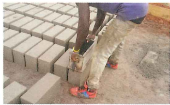
Stück für Stück in Handarbeit entstehen die Bausteine für den Kindergarten in Niaguis.
